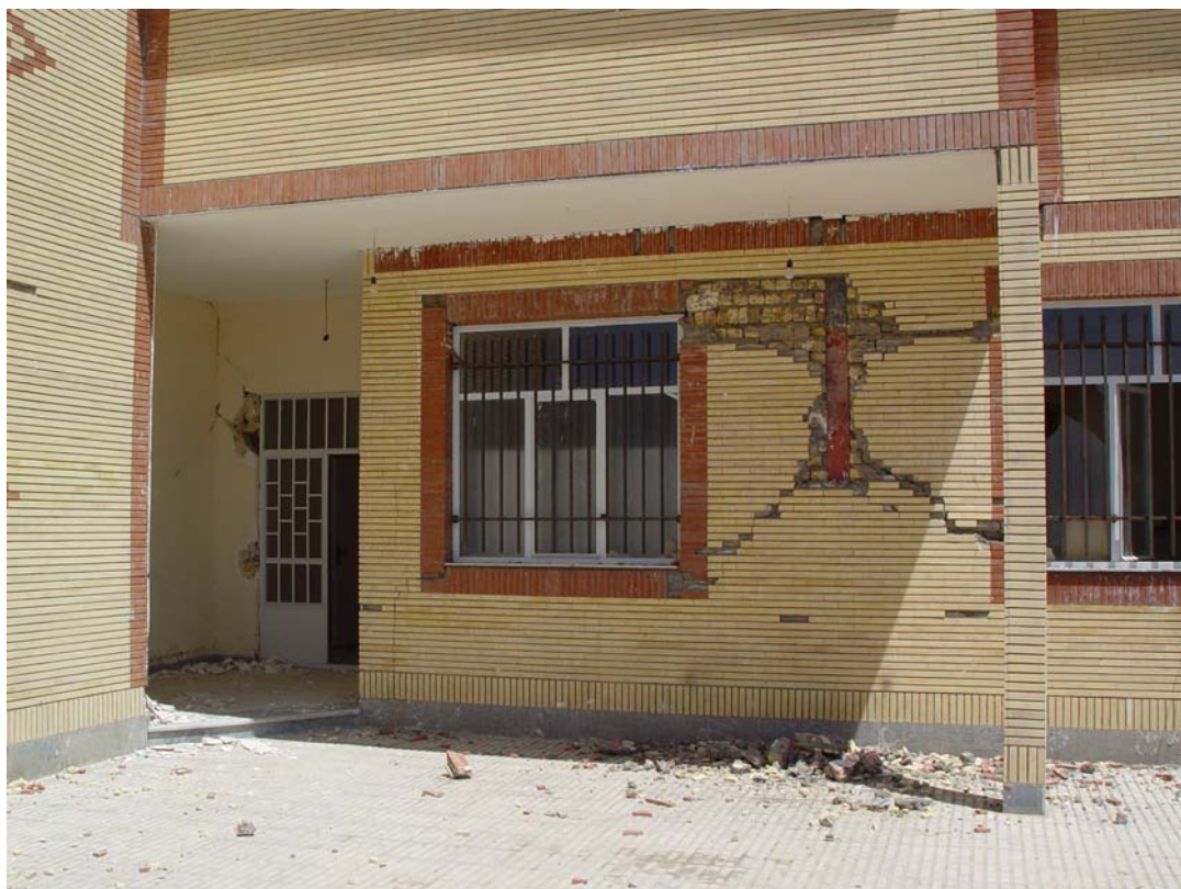
تصویر شماره ۷- ترک خوردگی برشی دیوار میانقاب در ساختمان تصویر ۶
