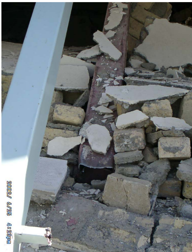
تصویر شماره ۱۴- بریده شدن کامل مقطع ستون در تراز سقف زیرزمین در ساختمان تصویر ۱۱
