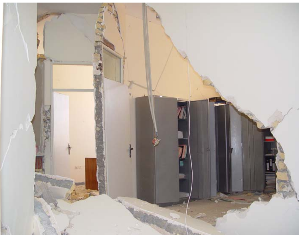
تصویر شماره ۸- ترک خوردگی برشی و ریزش تیغه جداگر در ساختمان تصویر ۶
