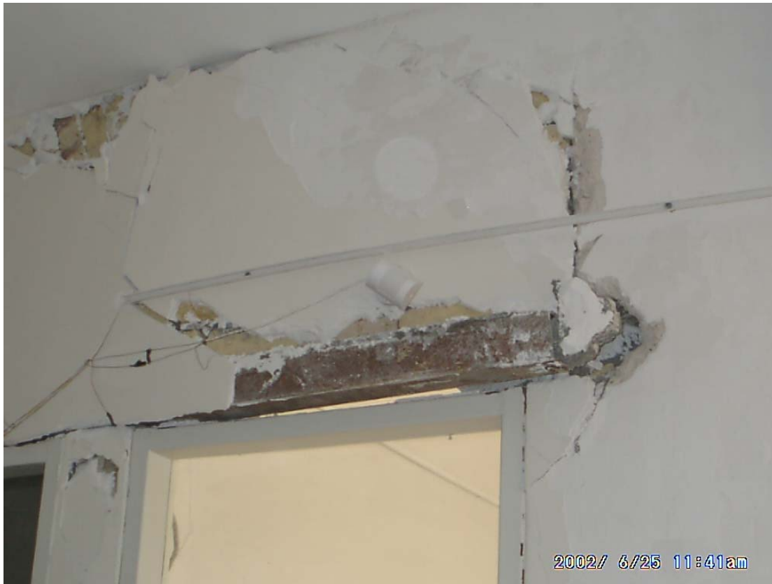
تصویر شماره ۳- خارج شدن نعل درگاه از دیوار در یک ساختمان اداری در بخش آوج
