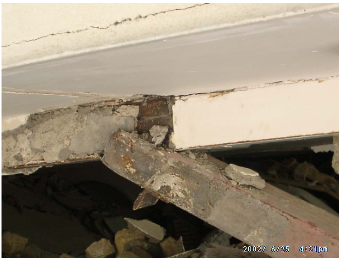
تصویر شماره ۱۲- انهدام اتصال تیر و ستون در ساختمان تصویر ۱۱
