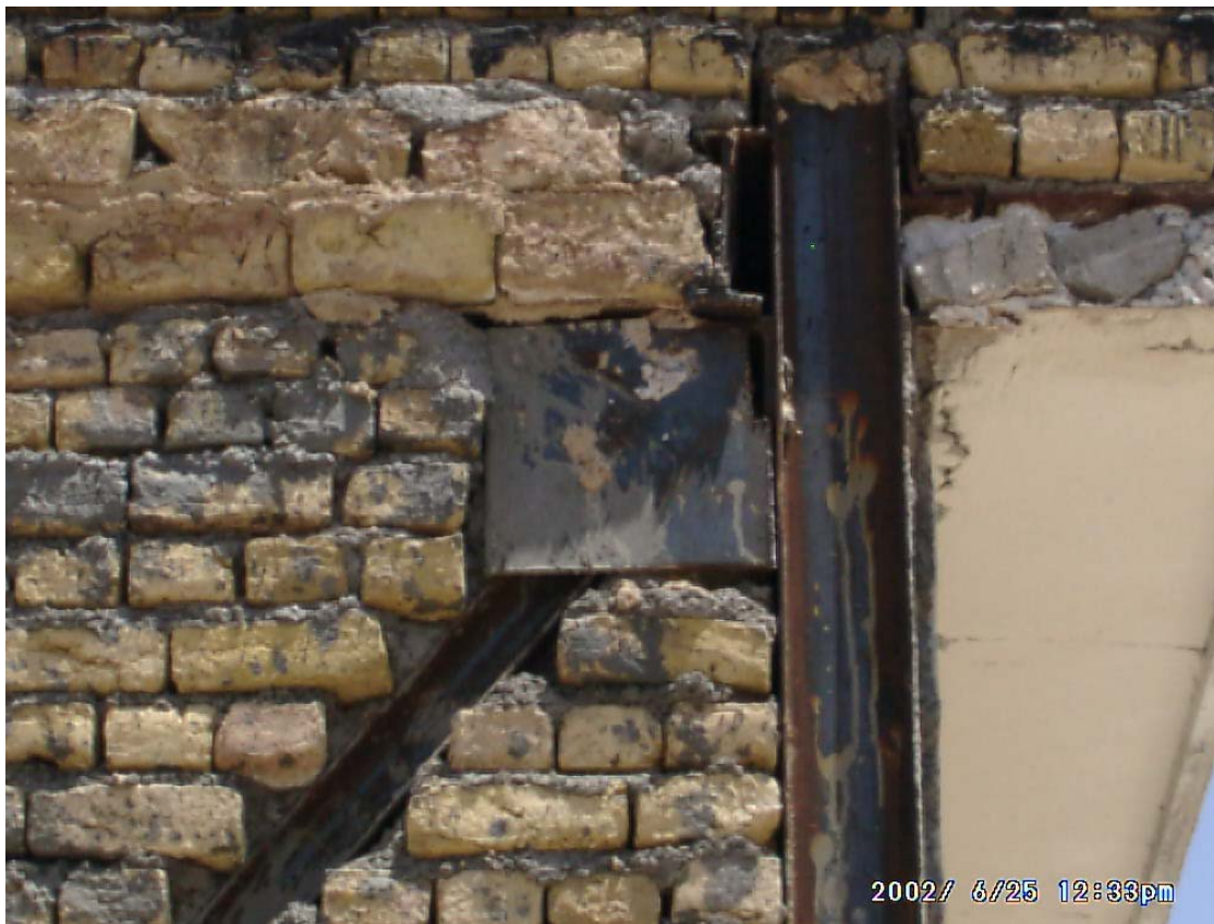
تصویر شماره ۱۰- اتصال غیرقابل قبول مهاربند و تیر و ستون در ساختمان تصویر شماره ۶
