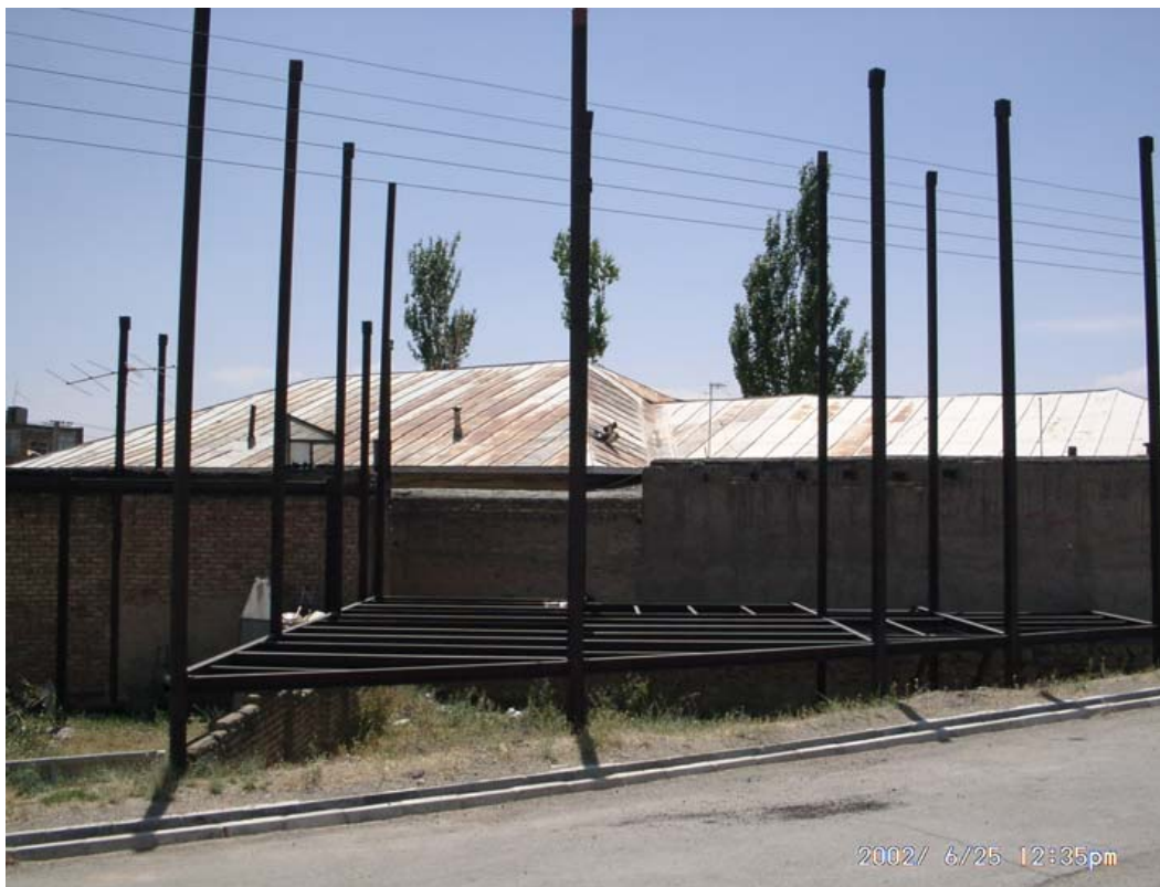
تصویر شماره ۴- اسکلت نمونه فولادی رایج در منطقه آوج شامل تیرها و ستون‌ها با اتصال ساده و بدون مهاربندی
