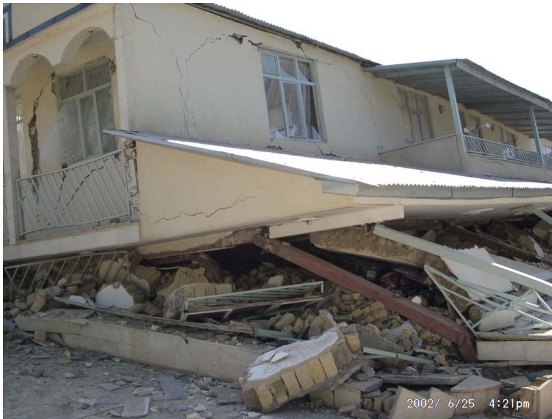
تصویر شماره ۱۱- انهدام طبقه همکف یک ساختمان ۳ طبقه در روستای چنگوره
