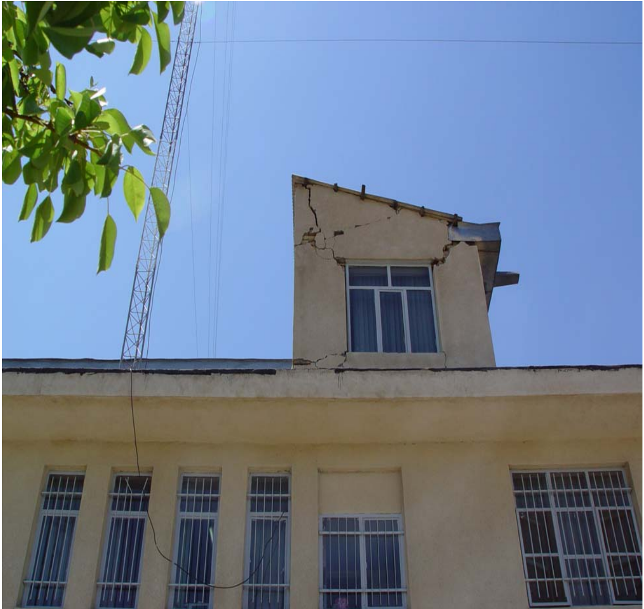
تصویر شماره ۱۵- ترک خوردگی دیوارهای خرپشته بام در ساختمان اداری در بخش آوج
